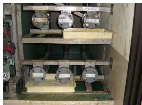
配管を集約した部分
